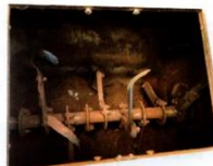
生ゴミ処理機の内部
